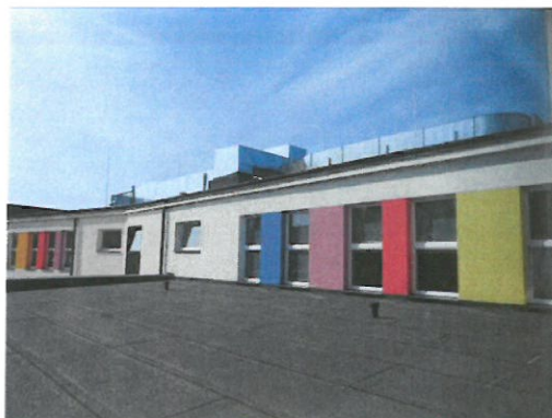
Pokrycie dachowe z instalacją wentylacyjną i solarną
