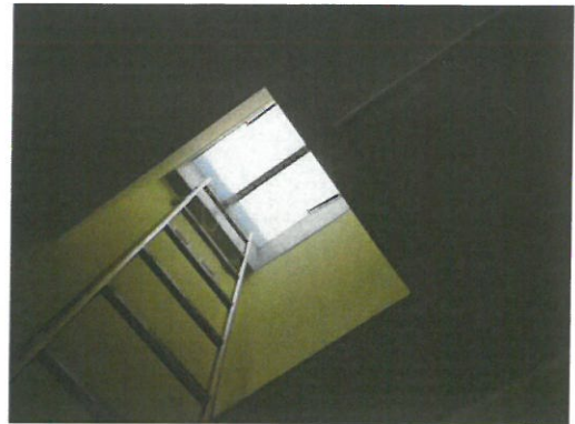
Właz na dach
