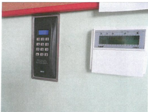
Domofon i zabezpieczenie alarmowe przy wejściu głównym do budynku
