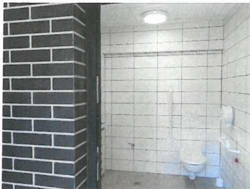
Łazienka zewnętrzna (przy sali widowiskowej) dostosowana do potrzeb osób z niepełnosprawnościami
