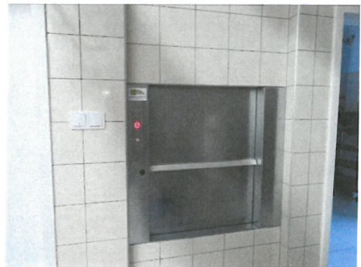
Winda towarowa w pomieszczeniu wydawalni posiłków
