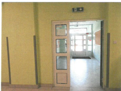
Wejście główne, zabezpieczenia krawędzi
