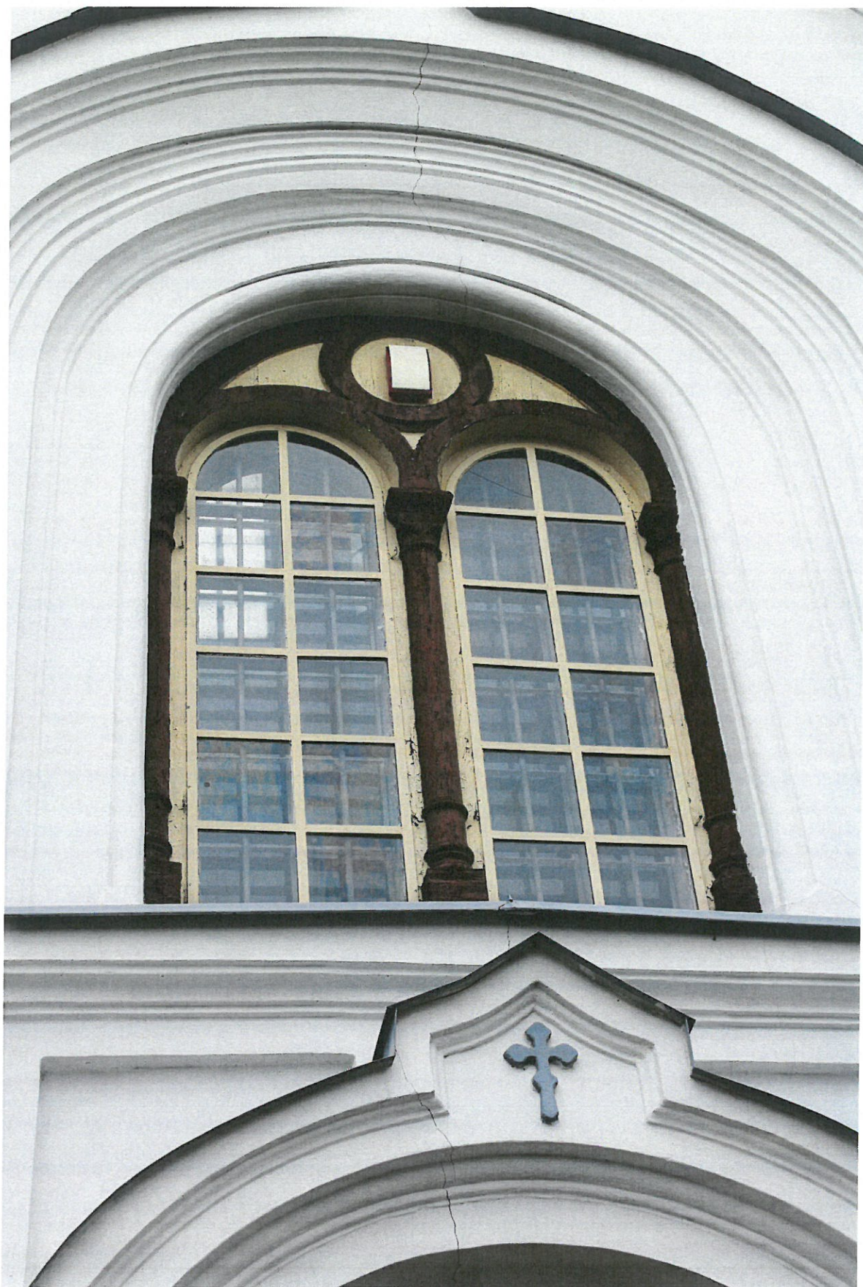
ZDJ. 7 WASILKÓW, CERKIEW PARAFIALNA P.W. ŚW. APOSTOŁÓW PIOTRA I PAWŁA. PĘKNIĘCIA MURU
